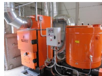
木材チップを燃料とする温風ボイラー
